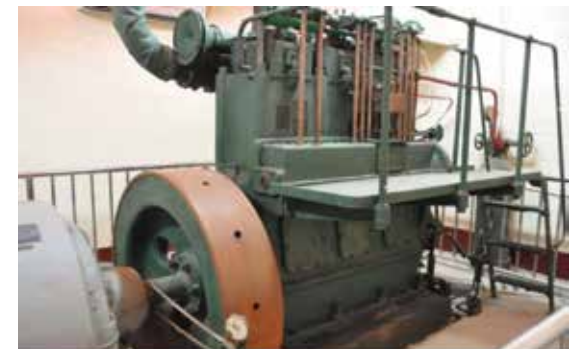
圖 25 鎮海樓地下指揮所之日遺發電機 資料來源：高雄市文化局官方網頁，〈鎮海樓簡介〉，網址： https://heritage.khcc.gov.tw/Heritage.aspx?KeyID=f08a7119-8ca0-45b6-9a18-3156291ace55 檢索日期：西元 2021 年 5 月 11 日
