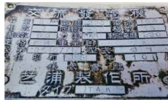
圖 24 鎮海樓地下指揮所發電機上之「芝浦製作所」之銘牌 資料來源：同註 27，頁 373 附圖 檢索日期：西元 2021 年 5 月 11 日
